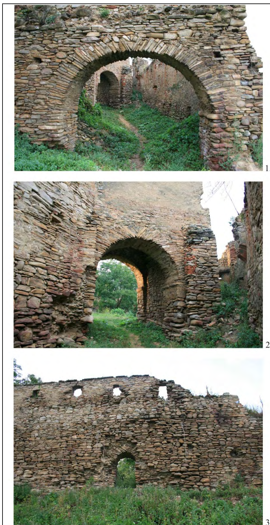
Pl. 2.1. Intrarea în cetate pe sub ruina Turnului de pază. 2. Intrarea în cetate pe sub turnul de poartă. 3. Zidul de incintă, detaliu de parament din interiorul incintei, latura de sud, între turnul de poartă și turnul muniției.
